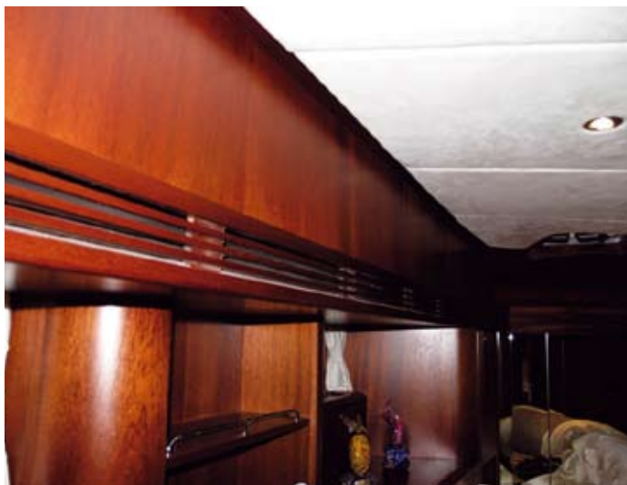
Interno di uno scafo dove le griglie di mandata aria sono state egregiamente ricavate facendo delle fresature esteticamente gradevoli
