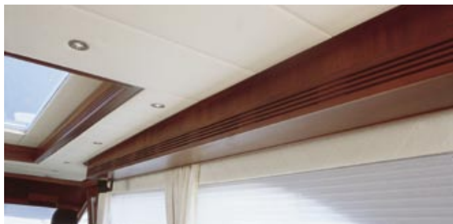
Griglie di mandata dell'aria perfettamente integrate a bordo di un Prestige 200 del cantiere Antema Yachting.
